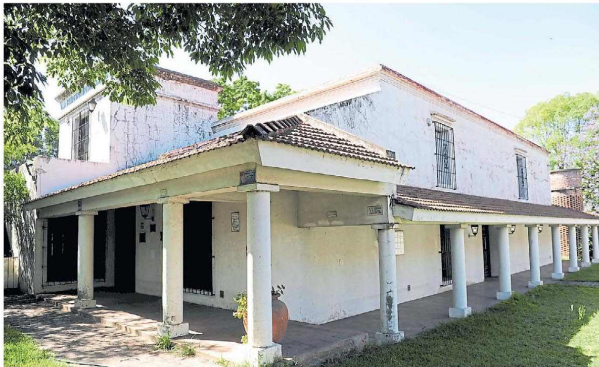
Fachada. El edificio está deteriorado y en los últimos años permaneció mayormente cerrado; la Fundación quiere venderlo. L. THIEBERGER
