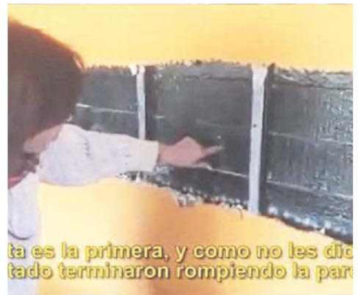
PAREDES. "Rompieron todo", se quejó la expresidenta, que en un tramo del video muestra los daños en una de las paredes.
