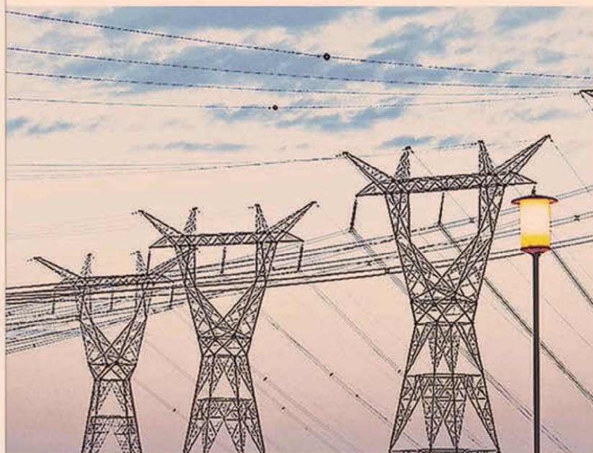
Energía concentró esfuerzos en la generación y la distribución eléctrica. AHORA REACTIVAN LA TRANSMISIÓN
